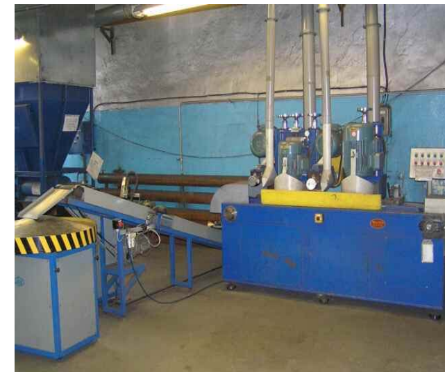
Neue Anlage fuer die mechanische Bearbeitung der Scheibenbremskloetze
